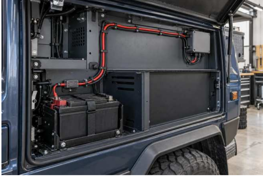
Şekil 1: Akü, korumalı güç bağlantısı ve elektronik muhafazaya uzanan uzun çift kablo güzergâhının bulunduğu açık araç servis alanı
