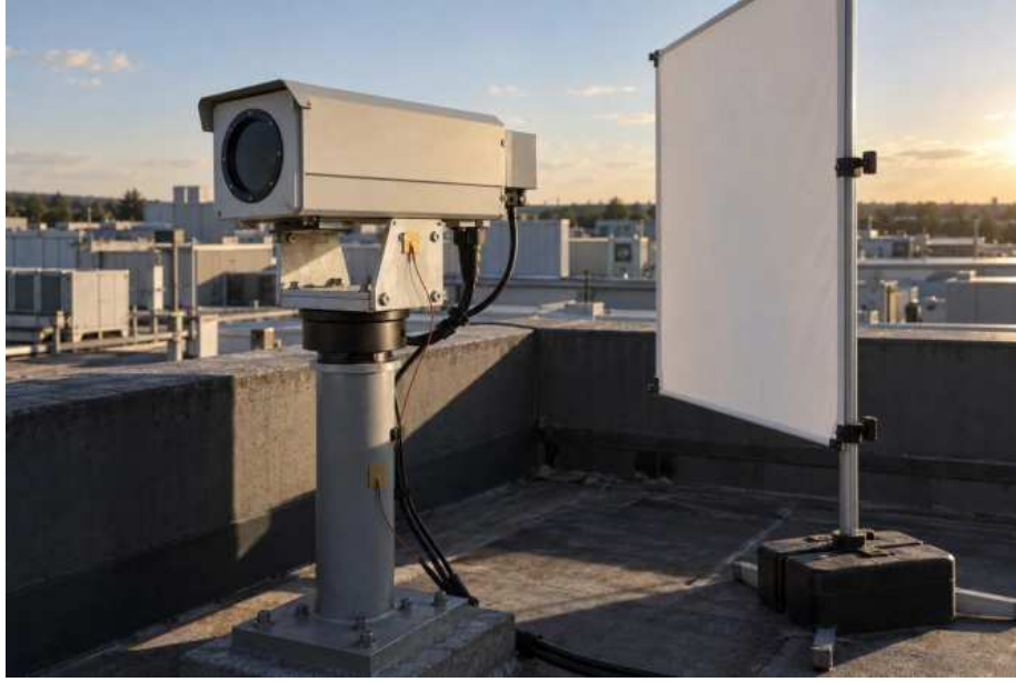
Şekil 4: Çatı kamerasında güneş gören braket ve gölgeli kaideye sıcaklık sensörü yamaları yerleştirilmiş; yanında ayrı bir gölgeleme paneli bulunuyor
